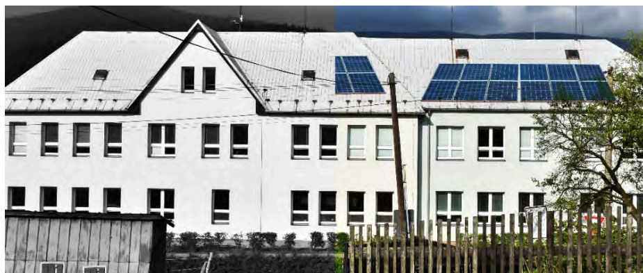
Fotovoltaika na škole
